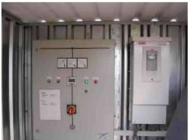
Quadro di distribuzione
